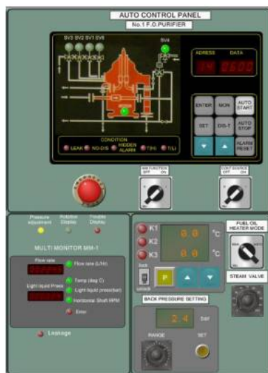
Slika 60. Kontrolni panel separatora goriva na kojem se može podešavati protok
