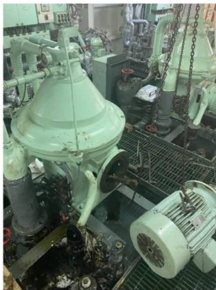
Slika 22. Separator prilikom održavanja
